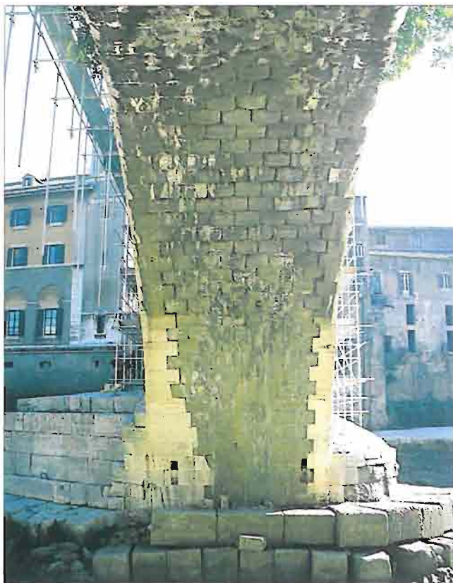
Figura 4 - Ponte Fabricio, sottarco (è visibile il degrado della pietra Gabina).
