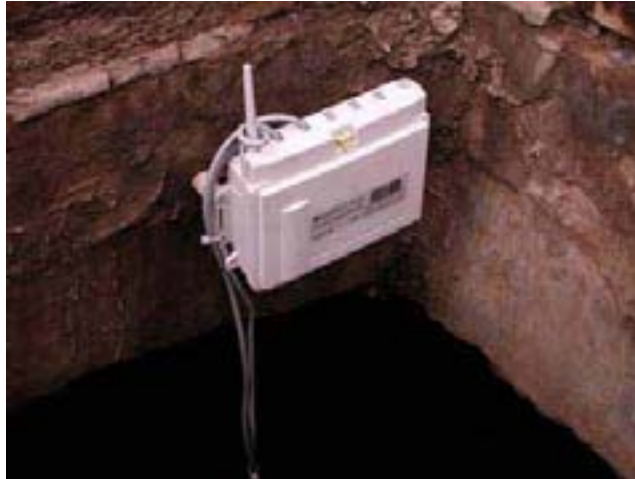
Figura 11 - Centralina locale di acquisizione e trasmissione dati
